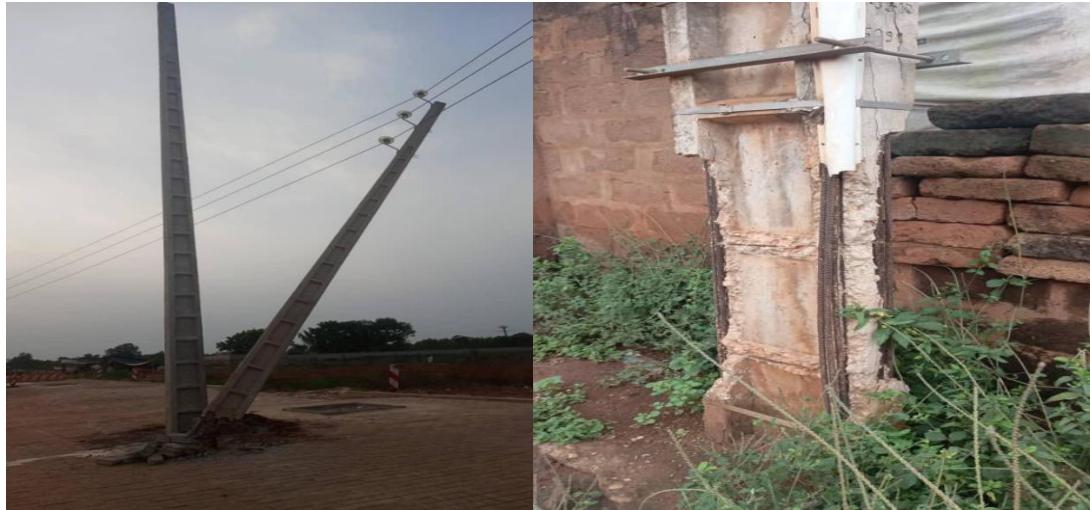
Figure 2. 3 : Poteaux en état de dégradation
