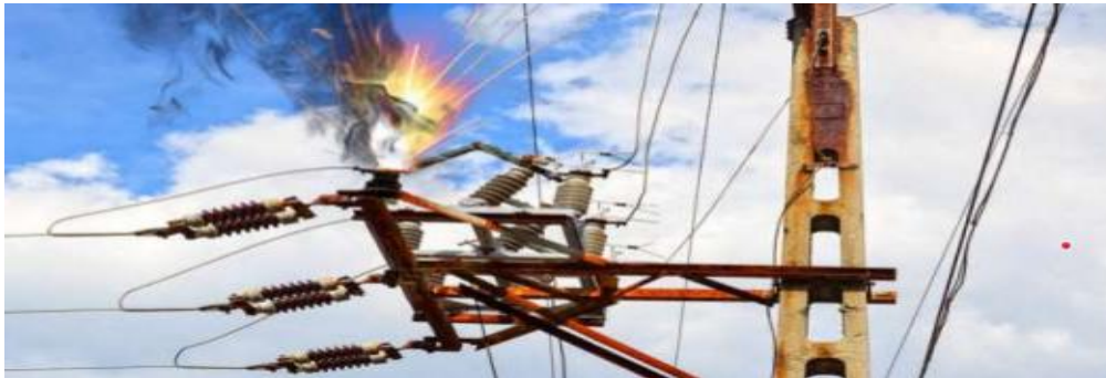
Figure 1. 2 : Défaut sur le réseau électrique
