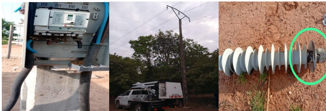
Figure 2. 4 : Compact vandalisé et parafoudre défectueux
