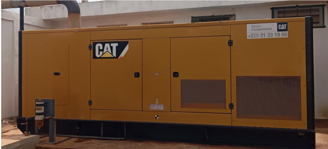
Figure A.4 : Groupe électrogène Caterpillar 660 kVA exploité par Fifa Bénin
