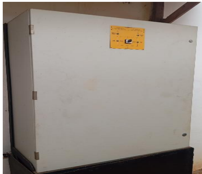
Figure A.7 : Armoire inverseur Normal-Secours de 1000 Ampère
