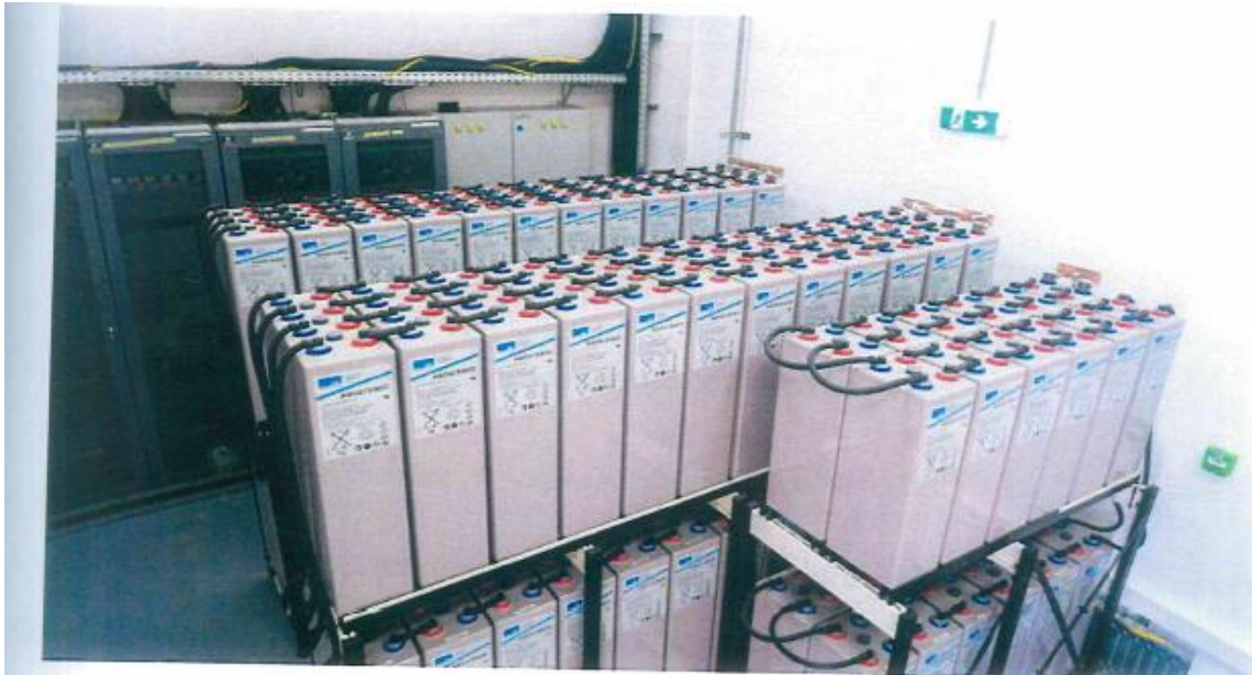
Figure 13 Câblage des batteries
