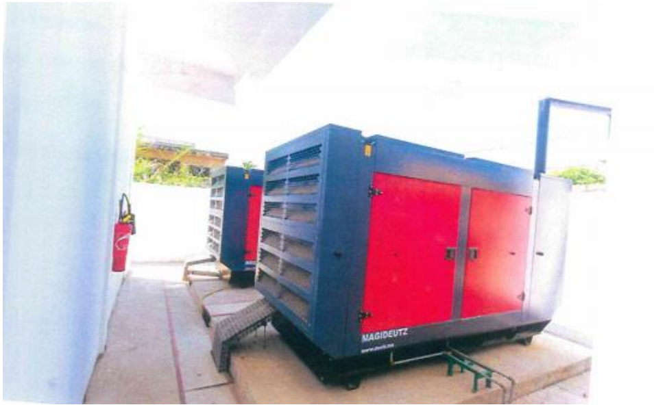
Figure 12 : Image des deux groupes utilisés pour le système de secours
