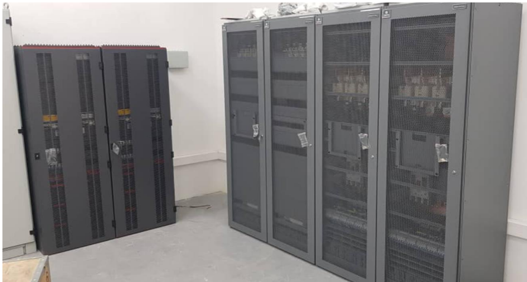
Figure 18 : Atelier d'énergie et Équipements du système RBO
