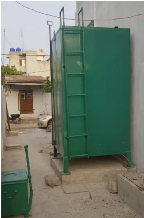
Figure 19 : Cuve à gasoil de 5000 Litres
