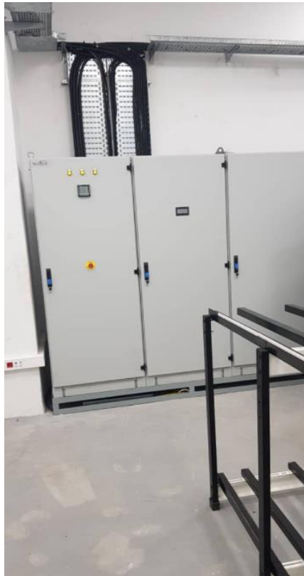
Figure 17: Tableau Général Basse Tension
