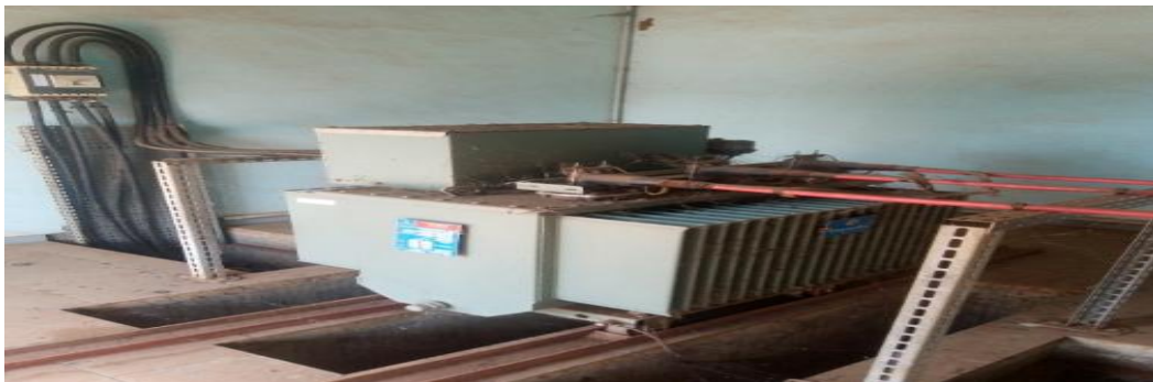
Fig3 : Transformateur en cabine de la Station d'eau d'Adja-Ouère
