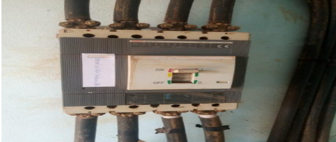
Fig1 : Disjoncteur Compact de 400 A sur le poste Po 5 (Poste Auto-Ecole /Pobè)
