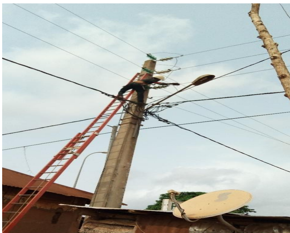
Fig2 : Remplacement de chaines d'isolateurs cassés
