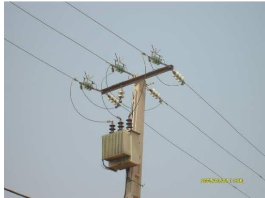
Fig2: Eclateur HTA protégeant un Transformateur
