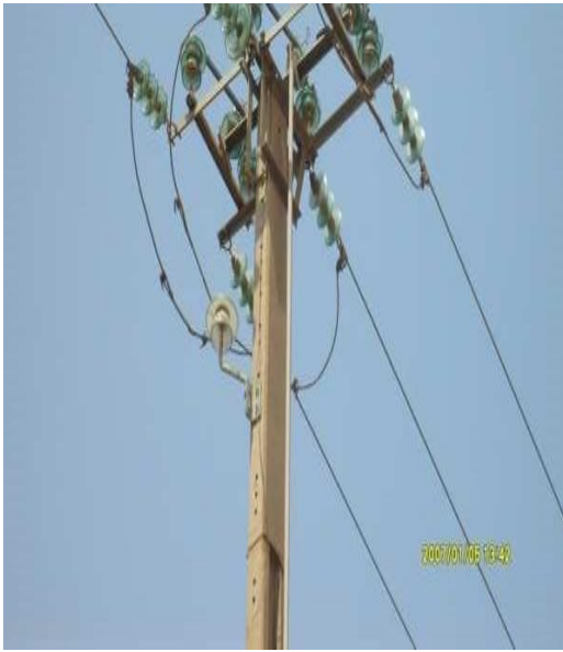
Fig2 : IACM de 31A défectueux et TOWE
