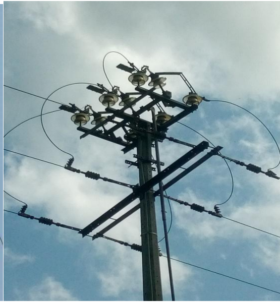
Fig3 : IACM de 100A sur la ligne HTA de Ponté à ISSABA
