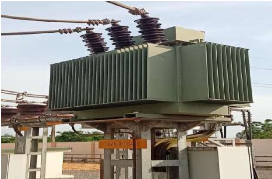
Figure 6 : Transformateurs de Services Auxiliaires TSA
