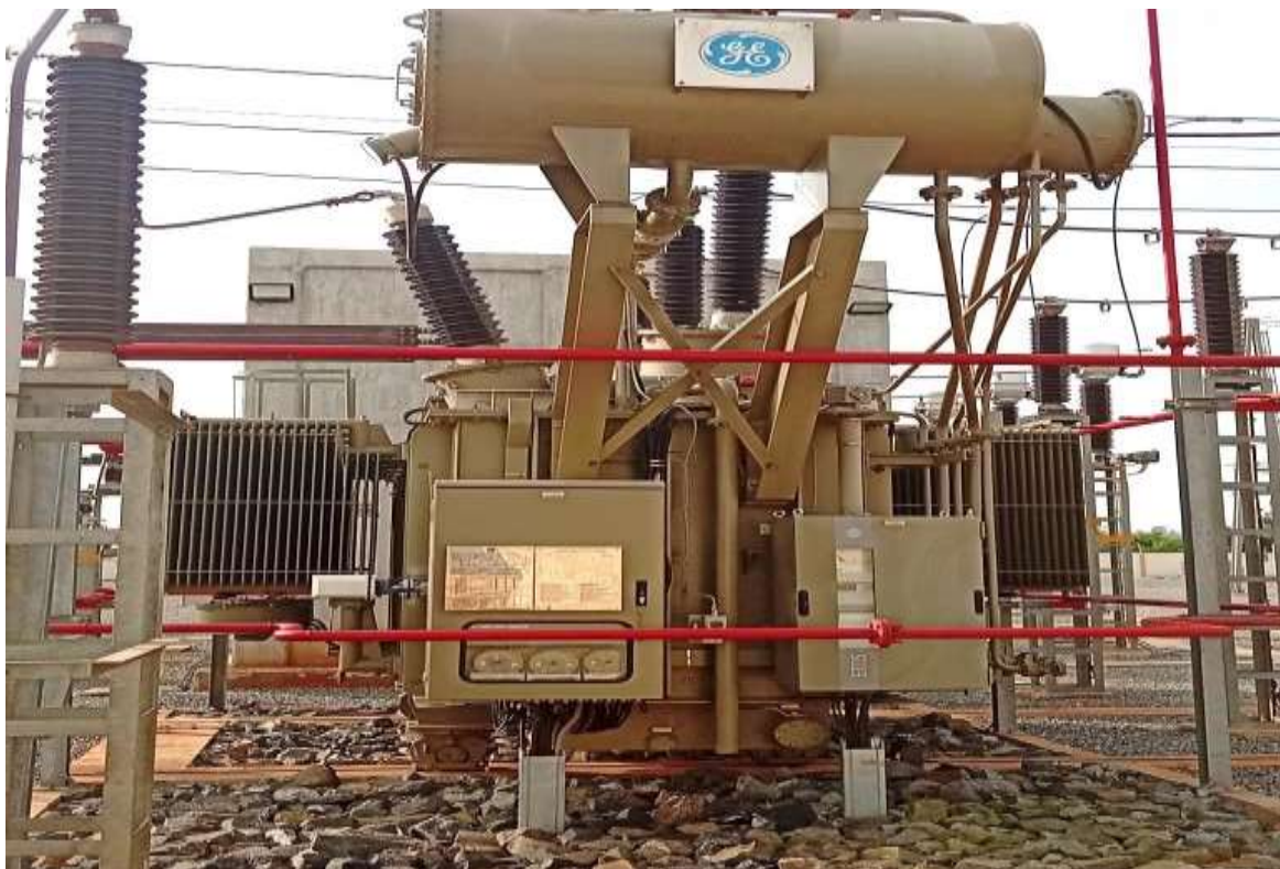
Figure 5 : Vue de profil du transformateur T1 161/20 kV 31,5 MVA.
