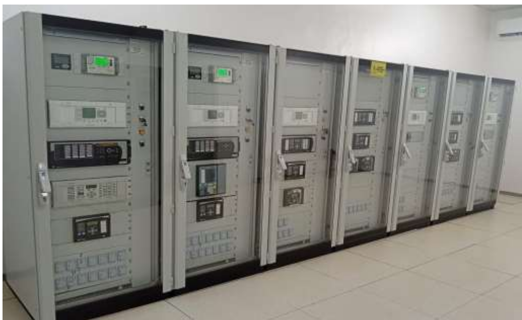
Figure 17 : Salle de relayage
